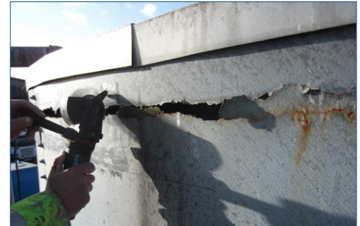
Поврежденные участки крупным планом
