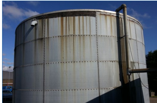
Резервуар, пострадавший от коррозии
