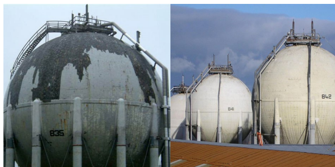
Защита изоляции резервуаров СПГ
