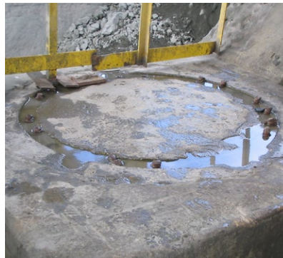
Поврежденный бетонный фундамент
