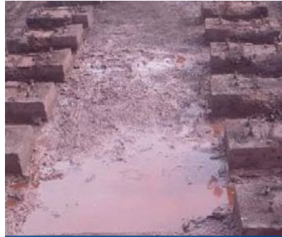
Поврежденные опорные блоки для рельсов
