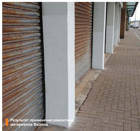
Ряд требующих ремонта бетонных колонн
