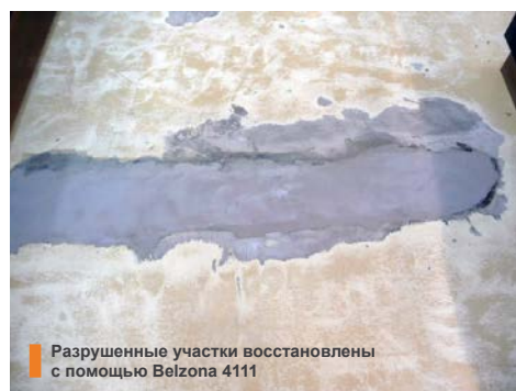
Поврежденное напольное покрытие
