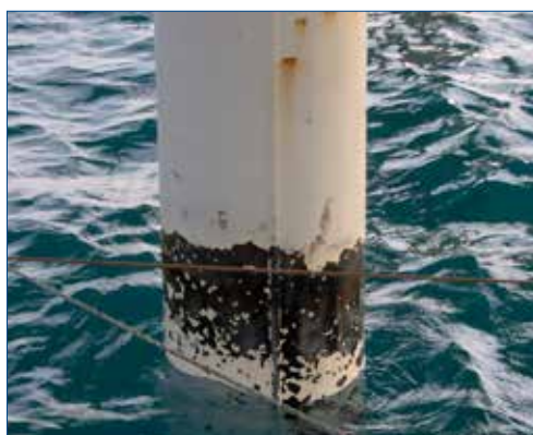
Коррозия опоры платформы
