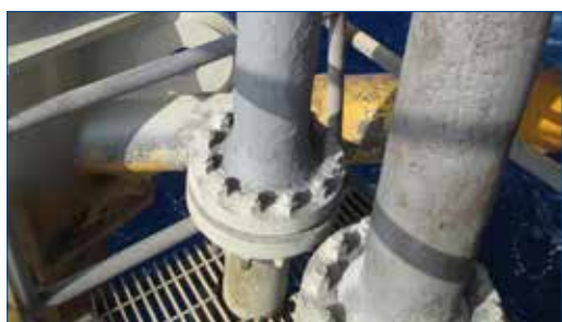
Питтинговые повреждения заполнены композитом Belzona 1121
